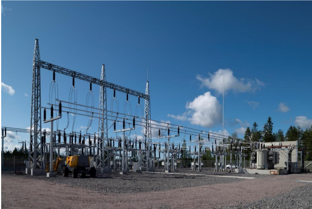
Kuva 5-5. Esimerkki tuulivoimahankkeen sähköasemasta. © Ilmatar Energy Oy.
